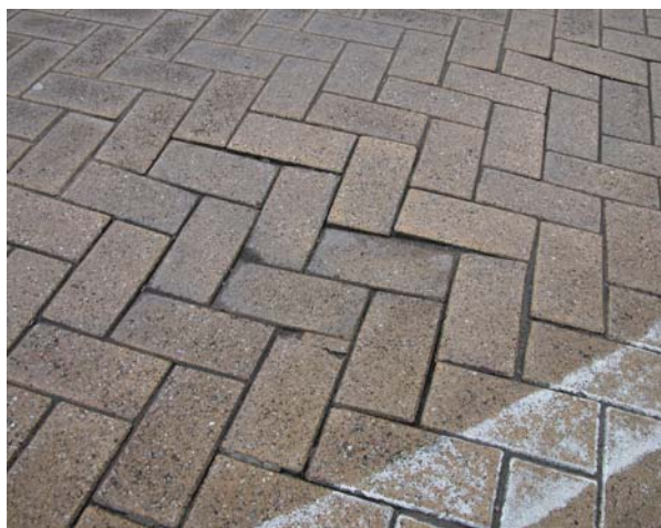
Figure 3: Suite à la dégradation, à la saponification (et au pumping), des affaissements font leur apparition, parfois sur l'épaisseur totale de la couche de pose.
